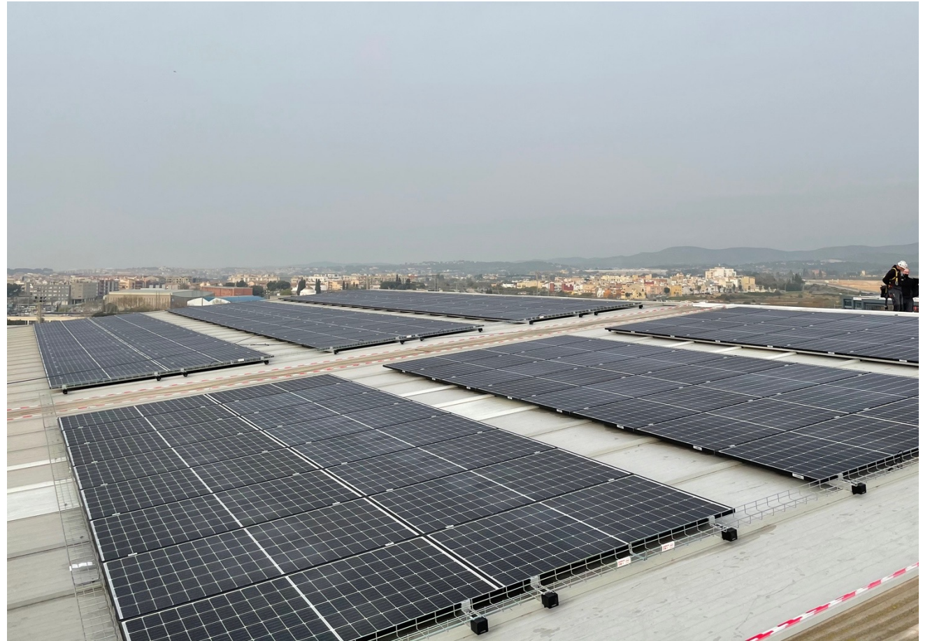
Imagen: cliente de autoconsumo de PROT energia en Vilanova i la Geltrú, instalación de 119 kWp con paneles REC sobre estructura VANDERVALK e inversores SMA.
