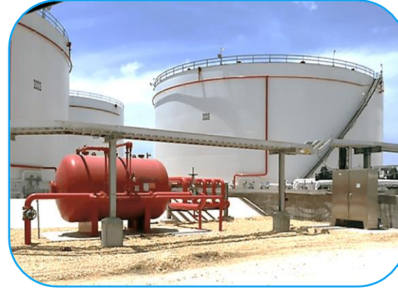
Sistemas de extinción de incendios
