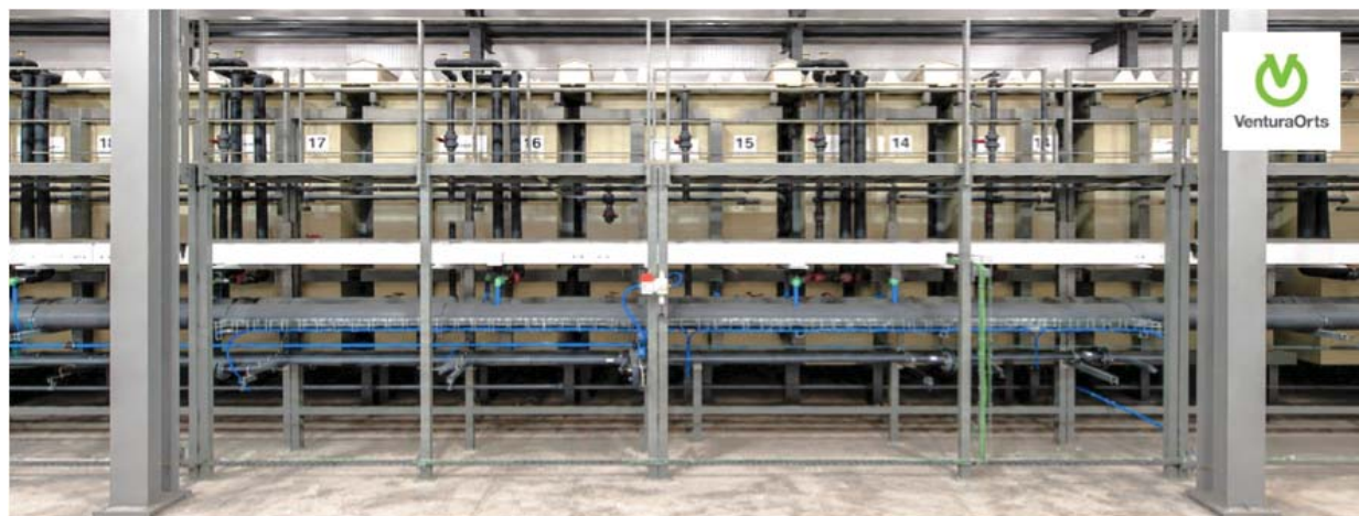
Línea de tratamiento de superficies desarrollada por Ventura Orts SA.
