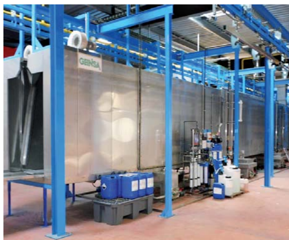
Vista del túnel de tratamiento suministrado por GEINSA
