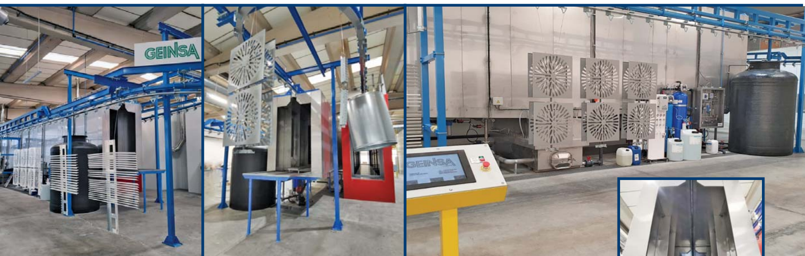
Vista de la instalación suministrada por GEINSA. Salida del túnel de tratamiento y horno de secado de humedad. Equipo de producción de agua osmotizada y pupitre de mando. Pieza en el interior del túnel de tratamiento GEINSA.
