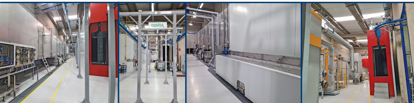
1. Túnel de tratamiento y horno de Polimerizado.
